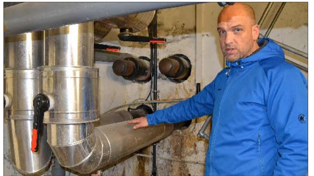
Diplom-Ingenieur Ingo Lübben zeigt auf die Vorlauf- und Rücklaufleitungen, die das heiße Wasser in die Gebäude innerhalb des Fernwärmenetzes transportieren. FOTOS: RASS
